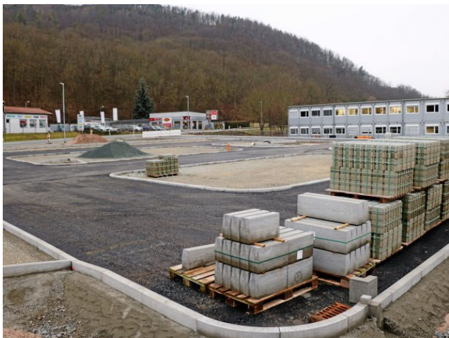
Eine eigene Zufahrt mit zusätzlichen Parkmöglichkeiten erhält das Staatliche Berufsbildende Schulzentrum Jena-Göschwitz. Im Hintergrund sind die Container zu sehen, in denen seit gut zwei Jahren einige Klassen unterrichtet werden, weil das Haus 3 gesperrt ist. Foto: Katja Dörn
